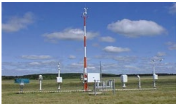
Estação Meteorológica Automática (AWOS)
